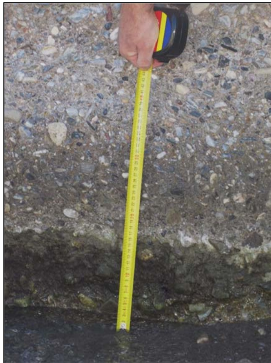
Εικόνα 5. Συνσεισμική ανύψωση εμφανής (18 εκατοστών) σε εγκαταλελειμμένο κυματοφραύστη στο Ποτοκάκι.
