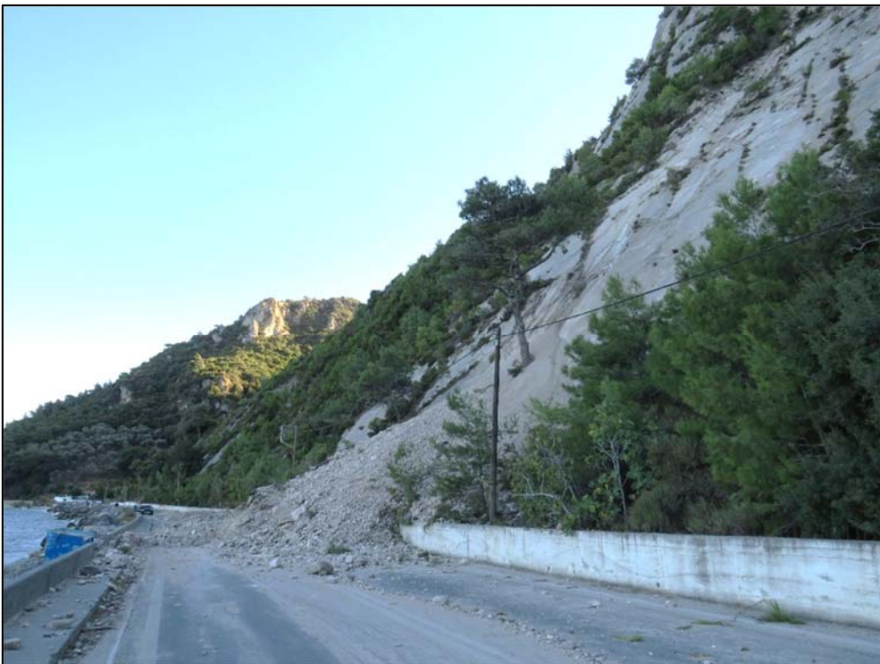
Εικόνα 7: Αστοχίες πρανών κατά μήκος του οδικού δικτύου από Βαθύ προς Καρλόβασι.
