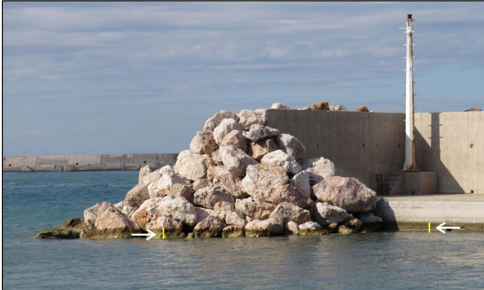
Εικόνα 1: Μόνιμη τεκτονική ανύψωση στο λιμάνι Καρλοβασίου. Έχει αποτυπωθεί στους βράχους προστασίας του λιμενοβραχίονα, αλλά και στην προβλήτα. Σύμφωνα με επιτόπιες μετρήσεις της επιστημονικής ομάδας του ΕΚΠΑ, η ανύψωση ανήλθε σε 24 εκατοστά.
